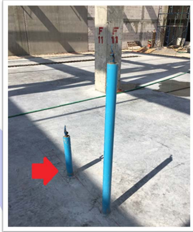
รูปที่ 10. รูปที่แสดงให้เห็นว่าแนวท่อน้ำอยู่กลางแนวผนัง อาจเกิดจากการใช้เส้นอ้างอิงไม่ตรงกัน
