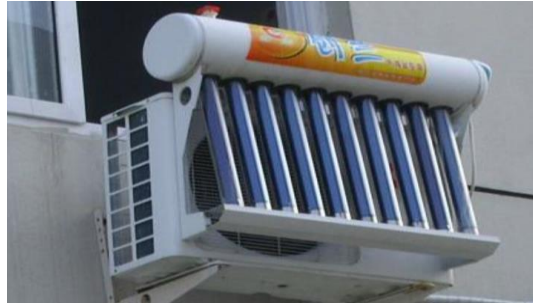
รูปที่ 4 การใช้ Solar air ของอาคารกองสื่อสารองค์กร ให้พลังงานแสงอาทิตย์ช่วยสร้างแรงดันน้ำยาในระบบต่อเนื่องจากคอมเพรสเซอร์ ทำให้คอมเพรสเซอร์ทำงานน้อยลง (ที่มา: http://www.priv.nrct.go.th/ebook_print.php?ebook_id=B0018 )
