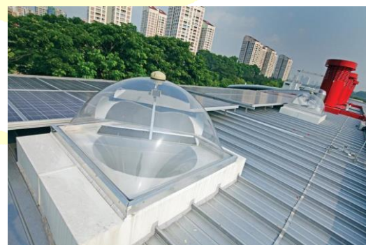
หลังคาติดตั้งแผงเซลล์แสงอาทิตย์ท่อนำแสง (light pipe) และปล่องระบายความร้อนจากในอาคาร (ส่วนสีแดง)
