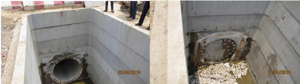
ท่อ ค.ส.ล ที่เชื่อมต่อระหว่างบ่อพัก ถึงบ่อ
